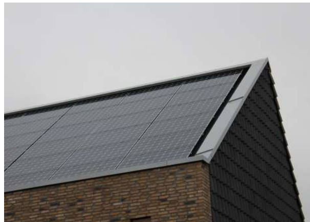
Voorbeeld van een achterdakvlak geheel bedekt met PV-collectoren
